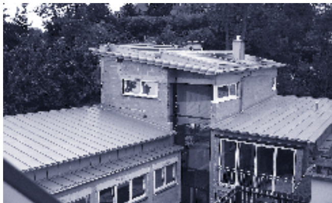
Pilotanlage auf dem Dach eines Einfamilienhauses
