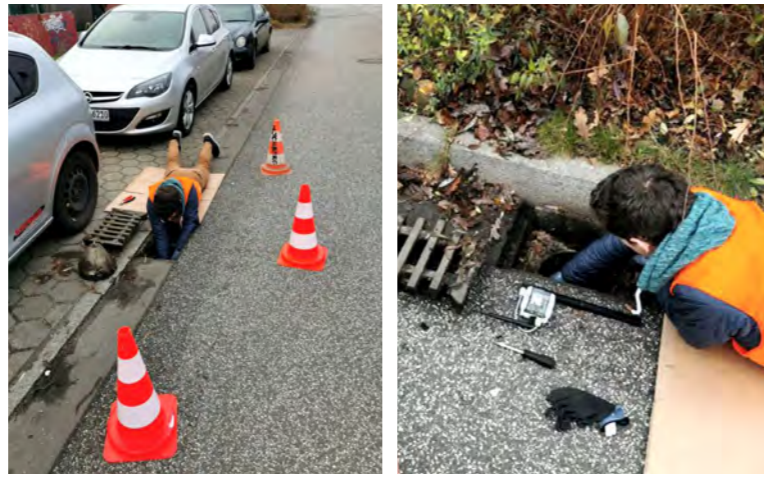
PROJEKT WATERGRIDSENSE 4.0 Forscher bei der Installation eines Sensors im öffentlichen Abwassersystem
