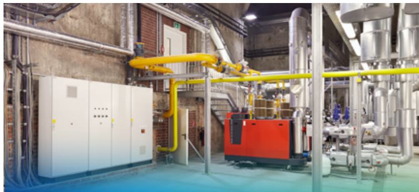
Bild: © HAMBURG ENERGIE
