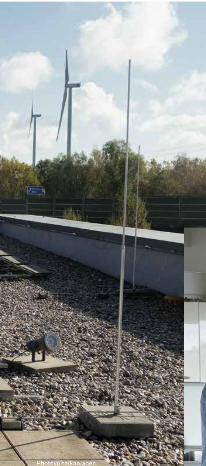
Photovoltaikanlagen auf dem Dach des Technologiezentrums Energie-Campus
